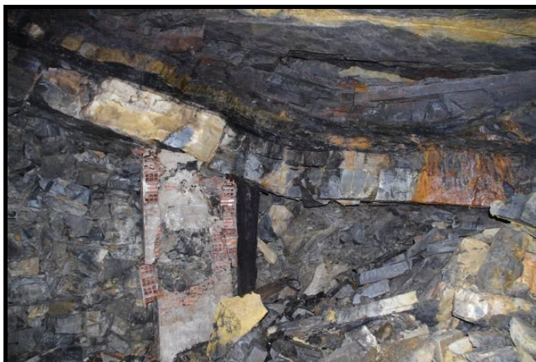
Photographie 3 : Fléchissement du toit dans une zone effondrée
